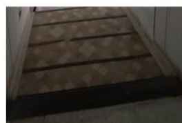
CINTA ANTIDESLIZANTE DESGASTADA
