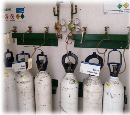
IMAGEN 2 Manifold Sede Canaima
