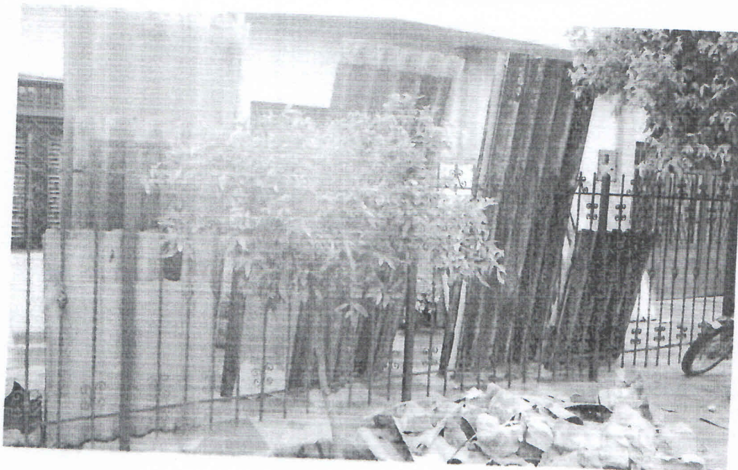
Foto No. 08 Fecha: mayo de 2018 Lugar: Neiva – Huila Obra: Remodelación casa de habitación Descripción: tejas de la cubierta en mal estado
