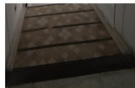
CINTA ANTIDESLIZANTE DESGASTADA
