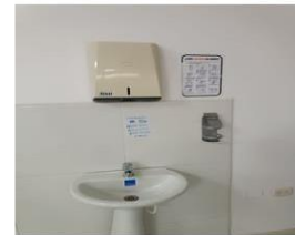
INSPECCION LAVADO DE MANOS
